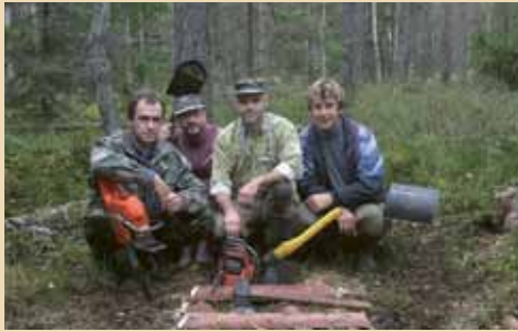
59. attēls. Aizsprostu būvniecības komanda pie uzbūvēta divrindu aizsprosta aizsargājamo ainavu apvidū „Ziemeļgauja”
