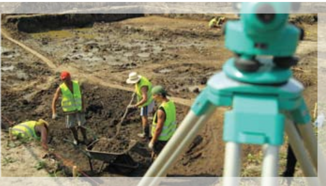
Arheoloģiskās izpētes darbi LU Dabaszinātņu akadēmiskajam centram paredzētajā būvniecības vietā Jelgavas ielā 1 Archeological excavations at the site of the UL Academic Center for Natural Sciences at Jelgavas iela 1
